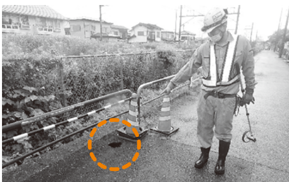
今井地区の道路陥没の様子
